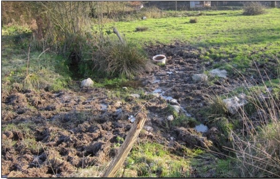
Passage d'animaux non protégé au dessus d'un cours d'eau.
